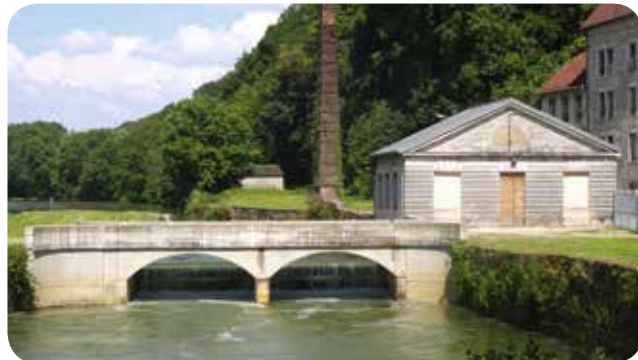
▷ L'installation actuelle avec les 2 groupes VLH immergés et le local technique réaménagé
