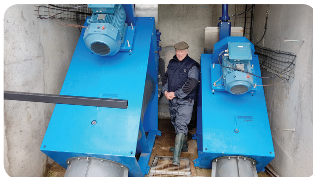
➤ Le propriétaire du moulin à côté des groupes Andritz Hydro de 22 kW et 9 kW
