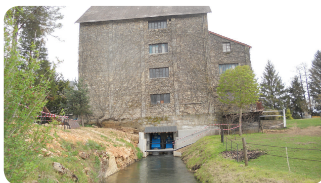
➤ Vue d'ensemble du bâtiment avec la nouvelle chambre d'eau et l'implantation des turbines en sortie du moulin
