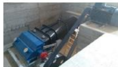
Centrale idroelettrica di Tarantasca (2018) Potenza 90 kW Produzione annua 410MWh
