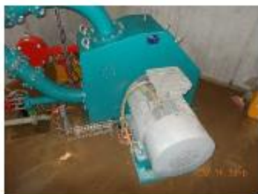
Centrale idroelettrica di Carpasio (2015) Potenza 100 kW Produzione annua 390MWh
