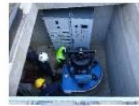
Centrale idroelettrica di Creusa (2021) Potenza 60 kW Produzione annua 350MWh
