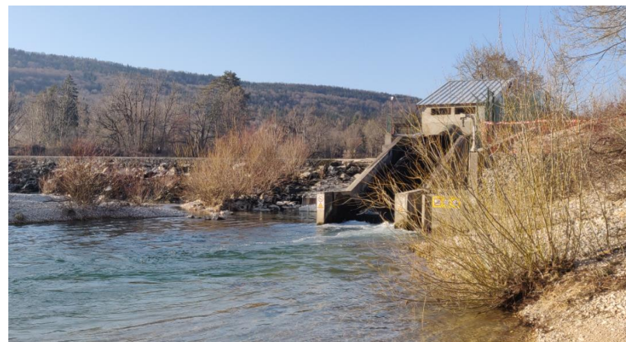
Vis hydroélectrique turbinant le débit réservé, centrale de Pont-du-Navoy (39).
