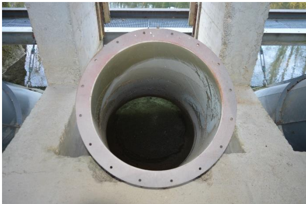
Vue d'un aspirateur en place
