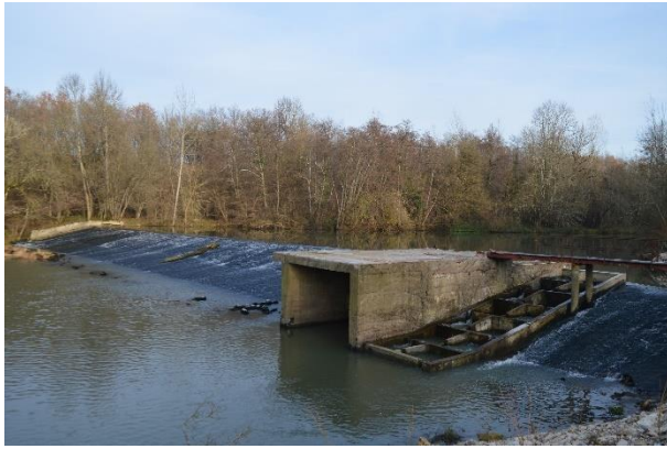
Seuil de Perrigny-sur-L'Ognon sur l'Ognon avec la passe à poissons
