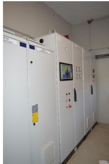
Armoires électriques et de commande
