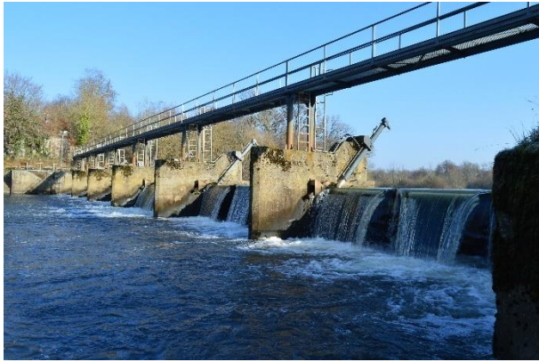
Clapets du seuil de Heuilley-sur-Saône sur la Saône
